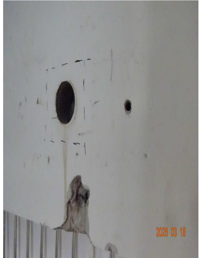
一层梁 C×4~5 轴, 混凝土强度 (钻芯法) 检测
