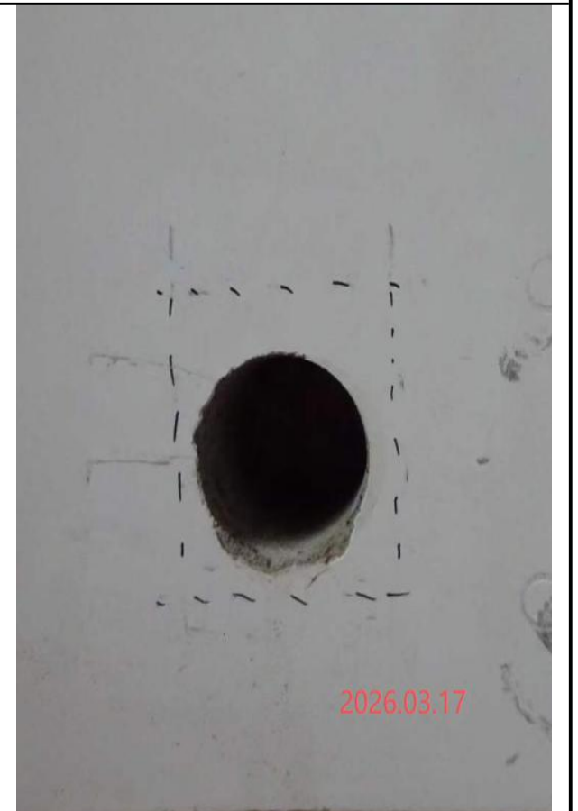
一层柱 4×E轴, 混凝土强度(钻芯法)检测
