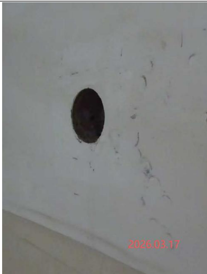
一层柱 1×E轴, 混凝土强度(钻芯法)检测
