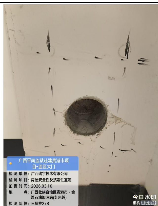
三层柱 3xB轴, 混凝土强度(钻芯法)检测
