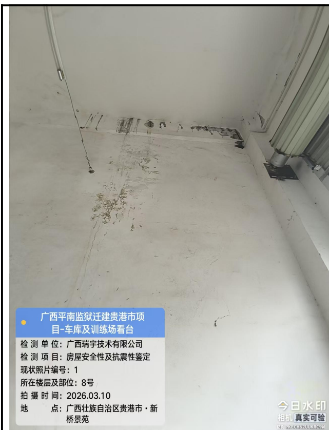
一层梁 5×D~C轴, 梁底露筋
