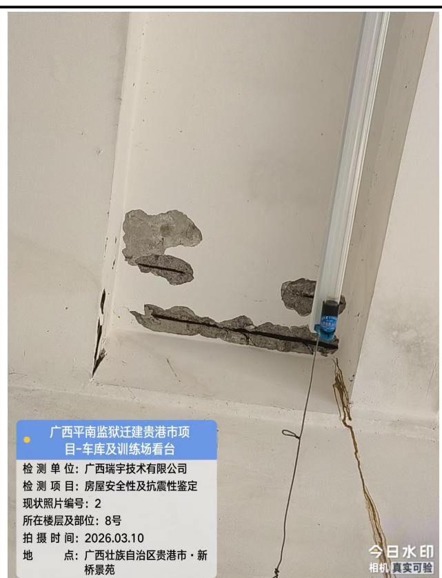
一层板 5~6×B~C轴, 板底露筋
