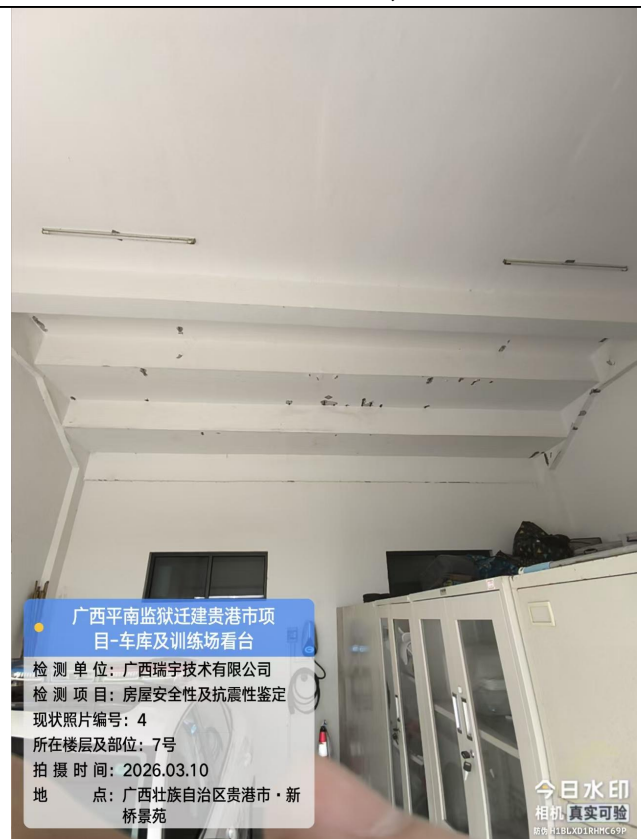
一层板 6~7×B~C轴, 板底露筋
