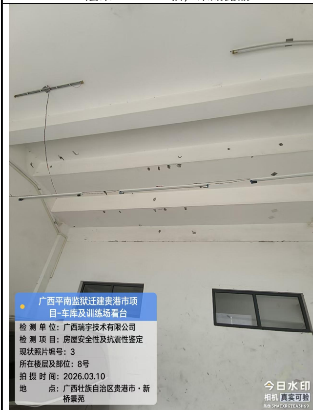
一层板 5~6×B~C轴, 板底露筋
